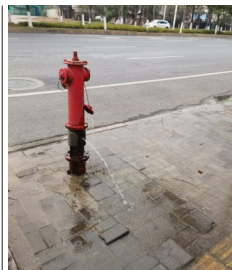
市城区桃花源路靠近柳叶大道附近人行道上,一处消防栓不停地向外流水。
